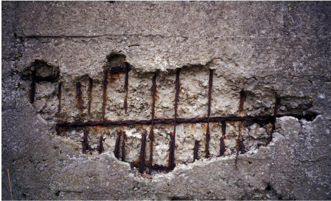
Διάγραμμα 2.3: Αποφλοίωση δοκού λόγω διάβρωσης του οπλισμού
