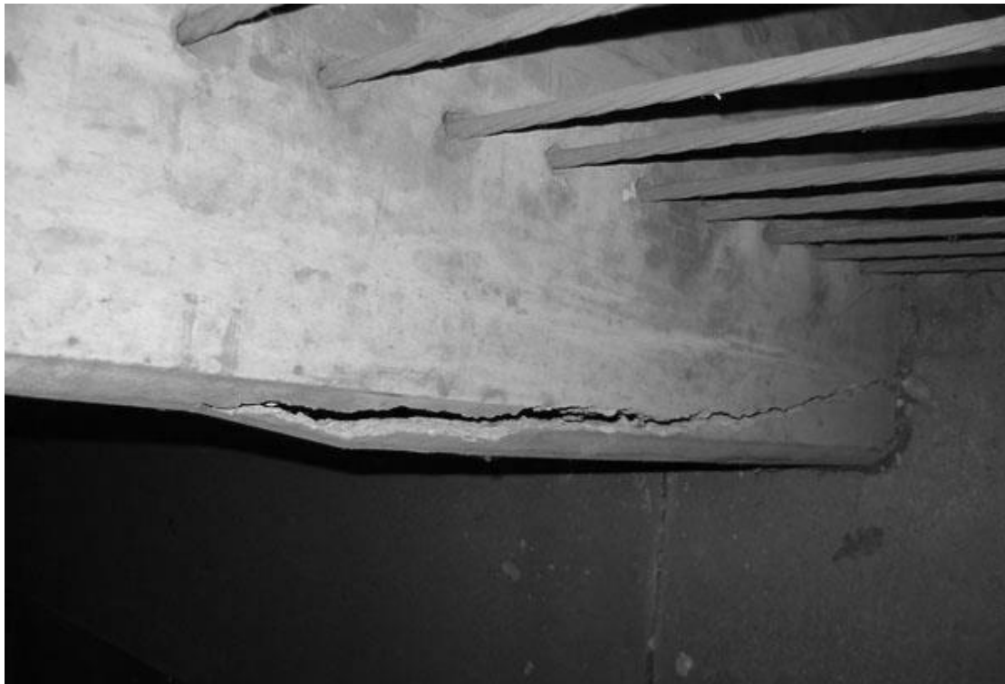
Διάγραμμα 2.1: Οριζόντια ρωγμή λόγω διάβρωσης σε δοκό χώρου στάθμευσης
