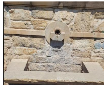
Κατεστραμμένη βρύση νερού
