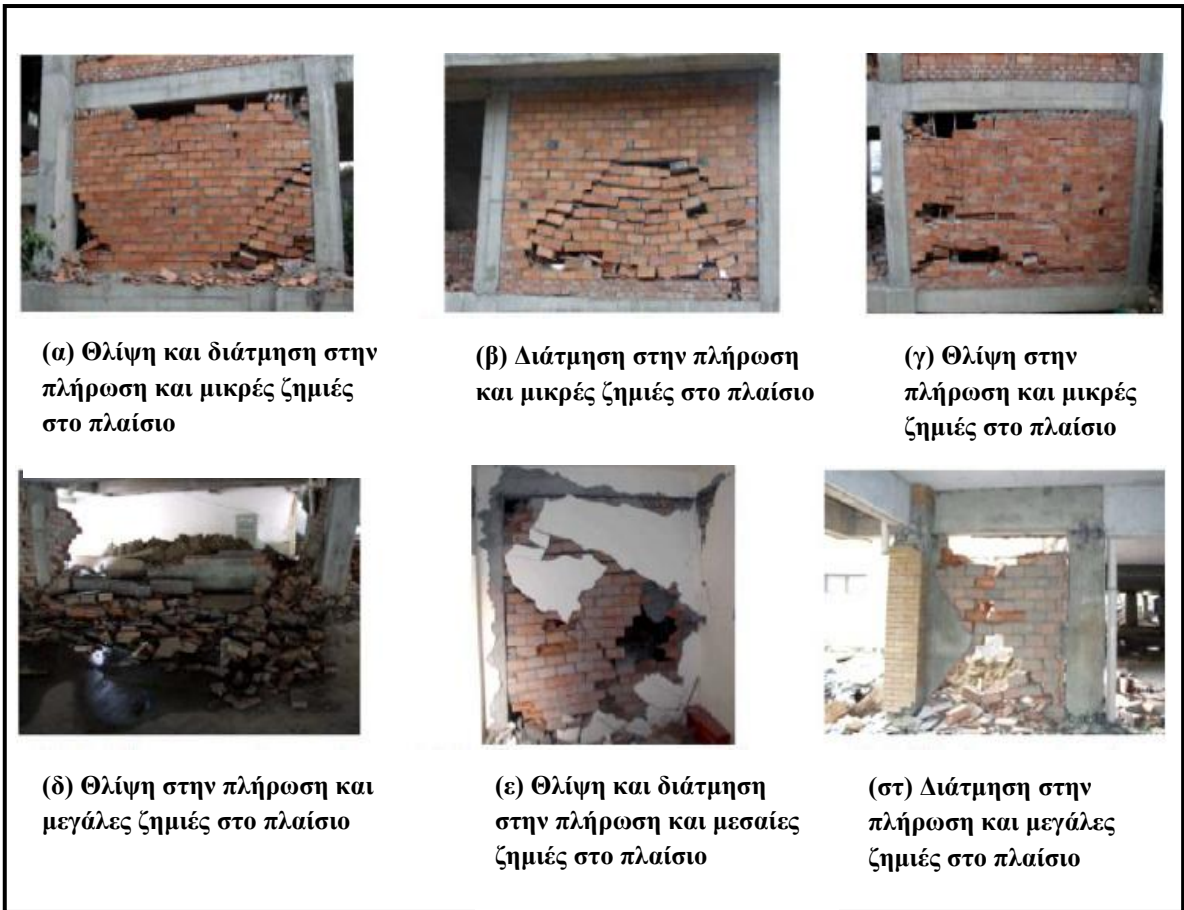
Εικόνα 1: Ζημιές σε τοιχοπληρώσεις σε πλαίσιο από οπλισμένο σκυρόδεμα μετά τον σεισμό Wenchuan (Bixiong, Li et al. (2008))
