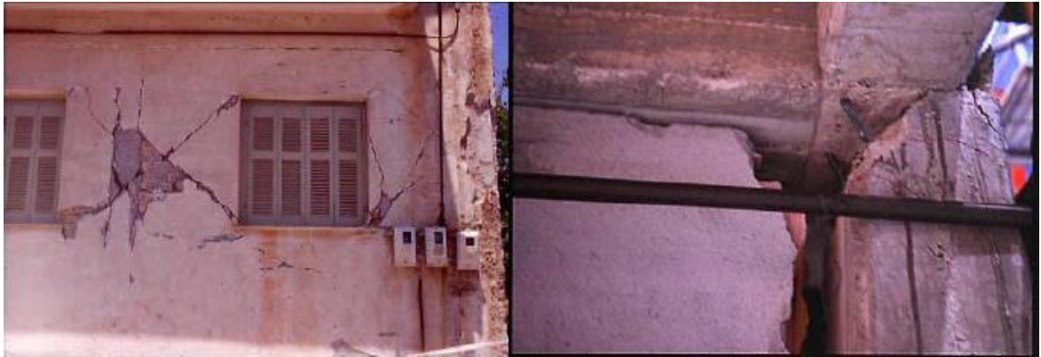
Εικόνα 5: Αστοχία υποστυλωμάτων λόγω ισχυρών τοιχοπληρώσεων
