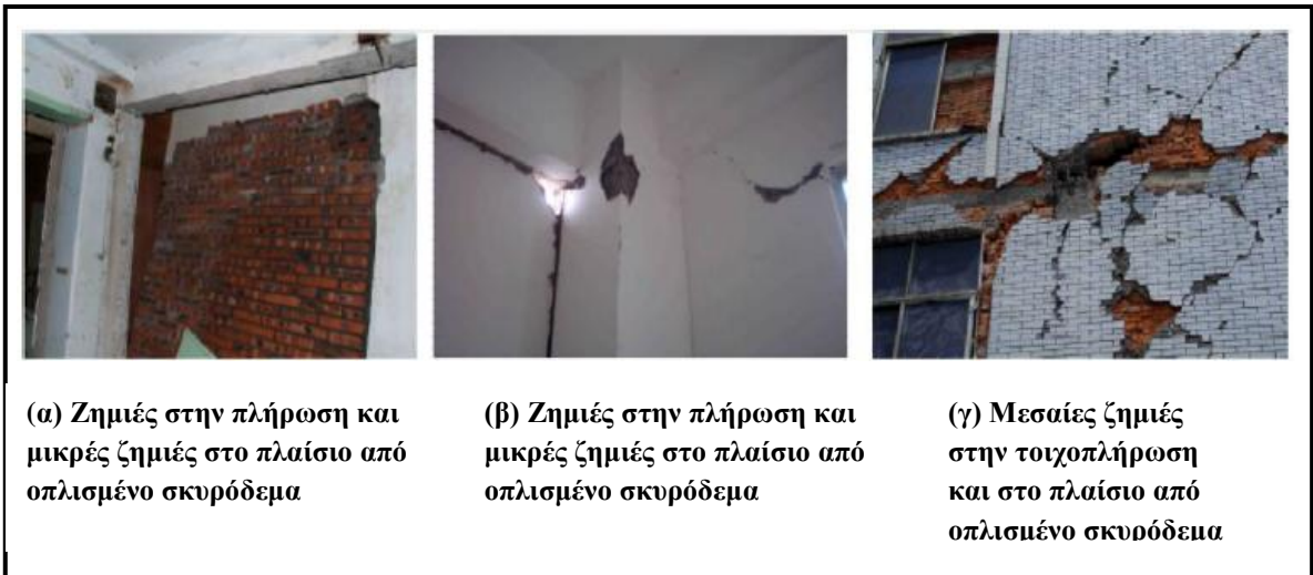
Εικόνα 2: Επίδραση συμπαγών τοιχοπληρώσεων στην συμπεριφορά της οριοθέτησης του πλαισίου από οπλισμένο σκυρόδεμα (Bixiong, Li et al. (2008))
