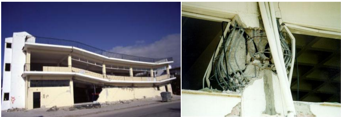
Εικόνα 4: Αστοχίες κοντών υποστυλωμάτων, σεισμός Αθήνας 1999
