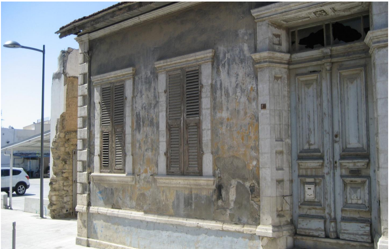
Φωτογραφία 4.2.1.2. : Εμφάνιση Κηλίδων Σκουριάς σε εγκαταλειμμένη κατοικία στην Παλιά Λεμεσό
