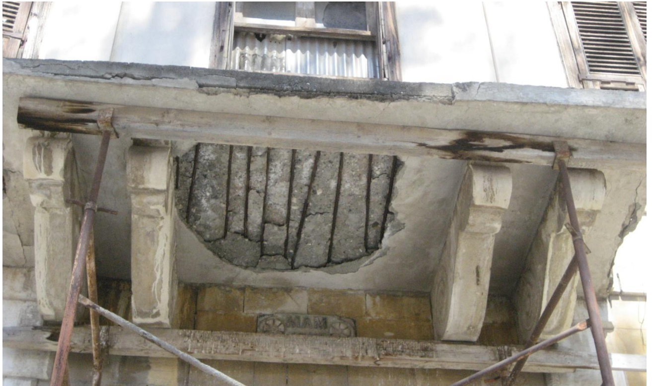
Φωτογραφία 4.2.1.4. : Εκτίναξη Επικάλυψης σε μαλακόνι σε Οικία στην Παλιά Λεμεσό
