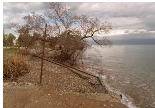
Εικόνα 3-6. Διάβρωση των ακτών της Δυτικής Αχαΐας.
