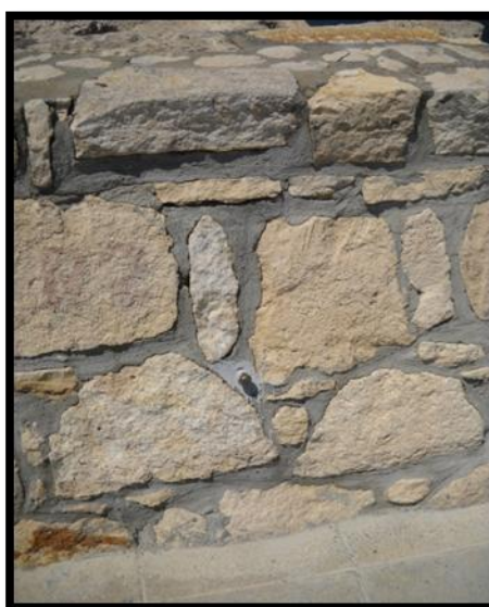
Εικόνα 2.2: Ορειχάλκινο μπουλόνιο, τοποθετημένο στο μαντρότοιχο
