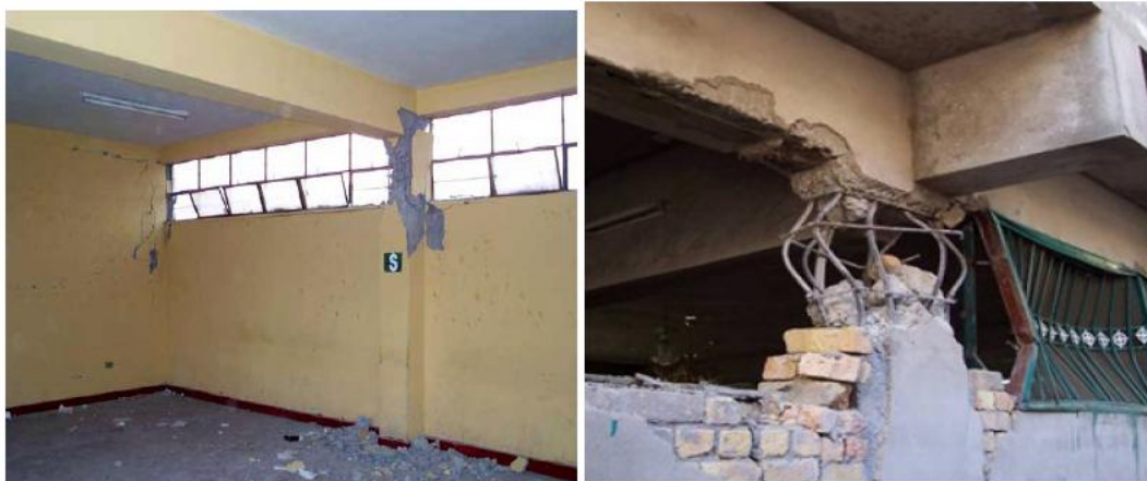
Εικόνα 104: Συνήθης τρόπος σχηματισμού και αστοχίας κοντών υποστυλωμάτων.
