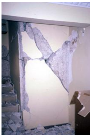
Εικόνα 93: Αστοχία σε διάτμηση
