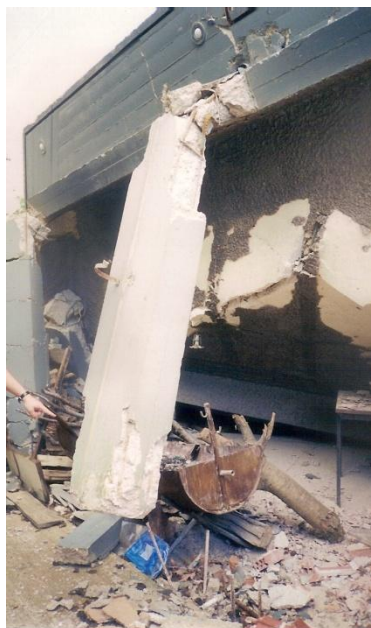
Εικόνα 99: Αστοχία λόγω κακής αγκύρωσης οπλισμού υποστυλώματος και πεδίου. Έλλειψη συνδετήρων στη βάση του υποστυλώματος.
