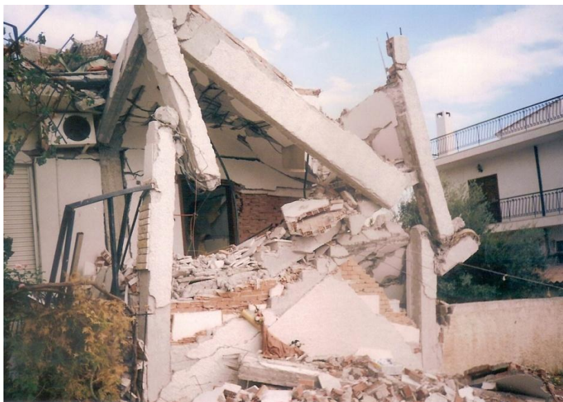
Εικόνα 97: Κατάρρευση κατοικίας από αστοχία υποστυλωμάτων (σεισμός Αθήνας 1999).
