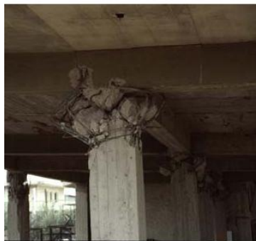
Εικόνα 118: Διατμητική αστοχία πάνω άκρου υποστυλώματος λόγω απουσίας συνδετήρων. Ο μανδύας συνδετήρων έφτανε μέχρι 0,5m κάτω από τη δοκό.
