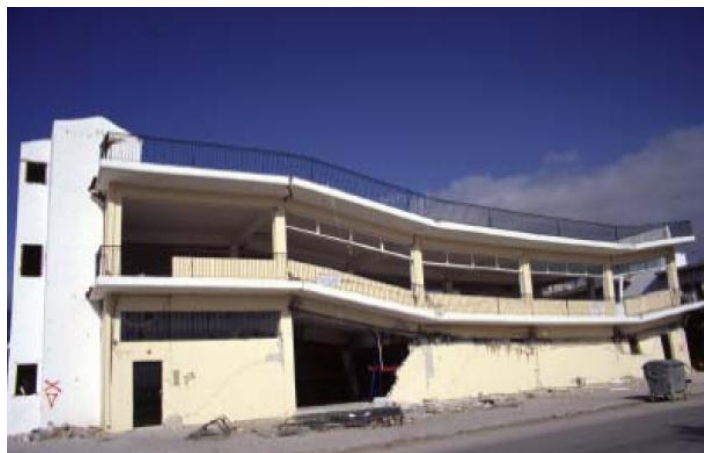
Εικόνα 103: Αστοχίες κοντών υποστυλωμάτων, σεισμός Αθήνας 1999
