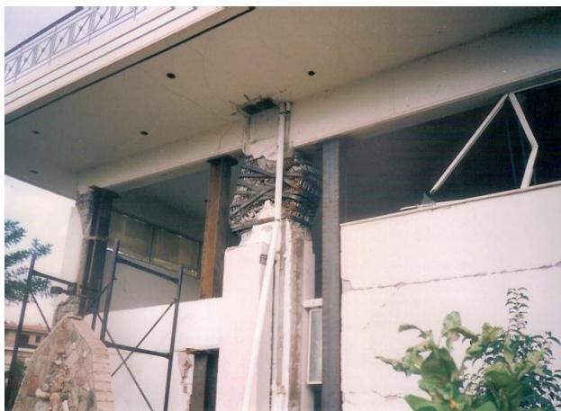
Εικόνα 105: Αστοχία κοντού υποστυλώματος και προσωρινή στήριξη με μεταλλικά στοιχεία.
