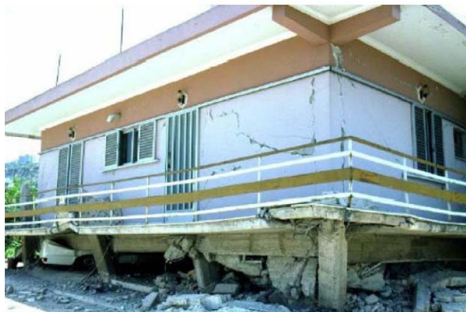
Εικόνα 101: Διώροφη κατοικία σε πιλοτή, σεισμός Αγίου 1995
