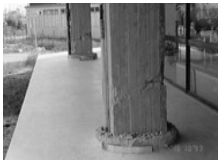
Εικόνα 89: Ρηγμάτωση υποστυλώματος λόγω κάμψης.
