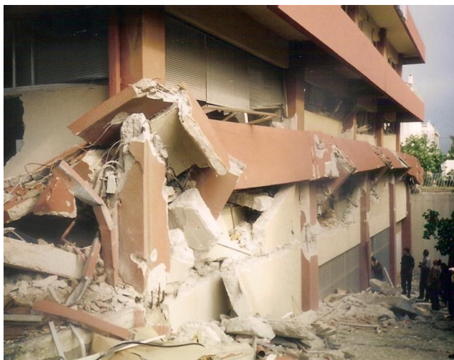
Εικόνα 102: Κατάρρευση μαλακού ορόφου σε σεισμό (σεισμός Αθήνας 1999)
