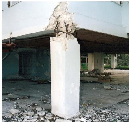
Εικόνα 117: Αστοχία στον κόμβο υποστυλώματος λόγω έλλειψης συνδετήρων
