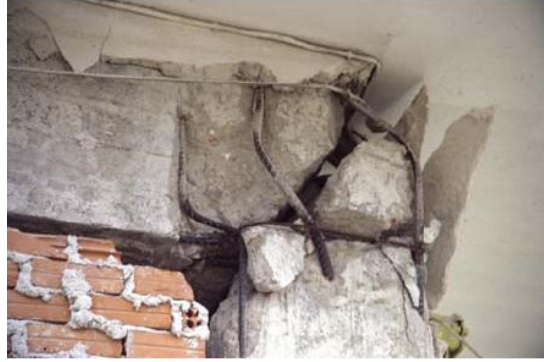
Εικόνα 116: Αστοχία εξωτερικού κόμβου και πρακτική απώλεια στήριξης δοκού.
