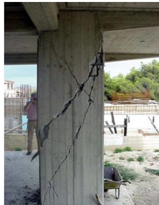
Εικόνα 91: Αστοχία Υποστυλώματος σε σεισμό λόγω τέμνουσας
