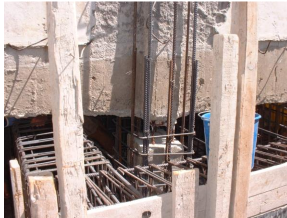
Εικόνα 83: Υπάρχει κενό στο υποκόλωνα αφού δεν έγινε καλά η σκυροδέτηση κατά την κατασκευή του σχολείου (Γυμνάσιο Κάτω Πύργου)
