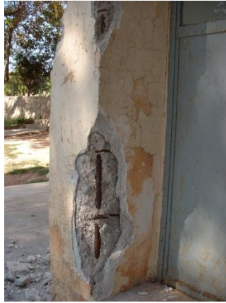
Εικόνα 90: Έλλειψη συνδετήρων σε υποστύλωμα (Δημοτικό Ίνειας)
