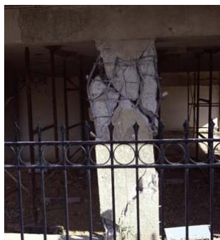
Εικόνα 94: Διατμητική αστοχία υποστύλωματος πάνω και κάτω με λυγισμό ράβδων και θραύση λεπτών και αραιών συνδετήρων.
