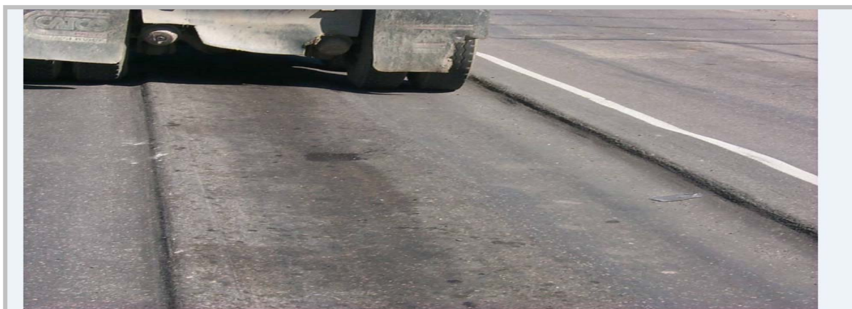
Εικόνα 14. Αυλάκωση και μετατόπιση του τάπητα καθίζησης κατά μήκος της τροχιάς των τροχών
