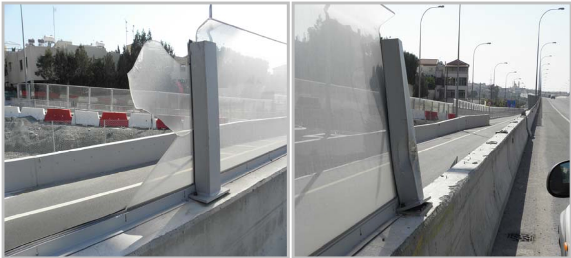
Εικόνα 57. Ζημιές σε Ηχοπετάσματα
