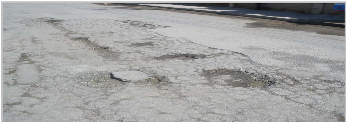
Εικόνα 12. Ρωγμές μορφής αλιγάτορα και λακκούβες.
