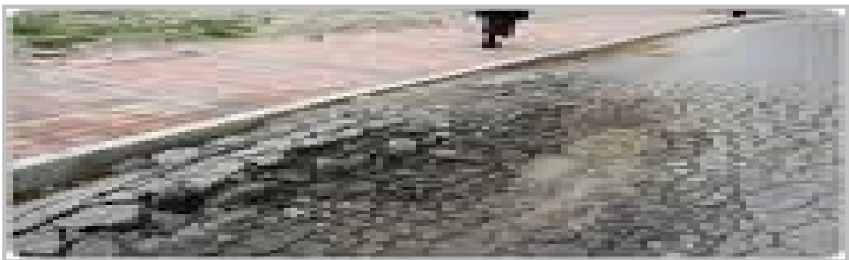
Εικόνα 17. Αποσύνθεση της επιφάνειας του οδοστρώματος
