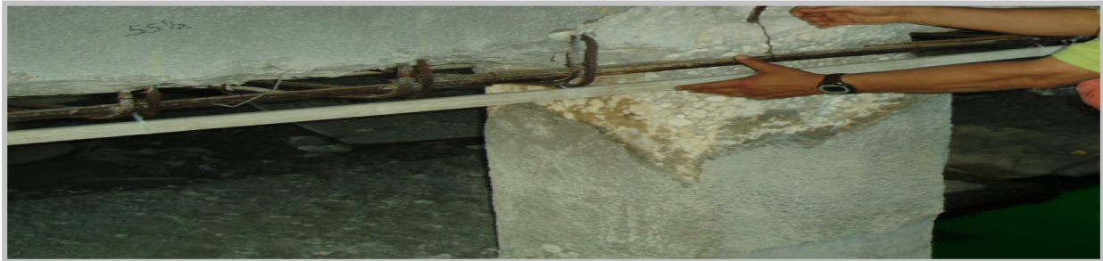
Εικόνα 46. Μέγεθος επιδιόρθωσης ζημιάς σε γέφυρα
