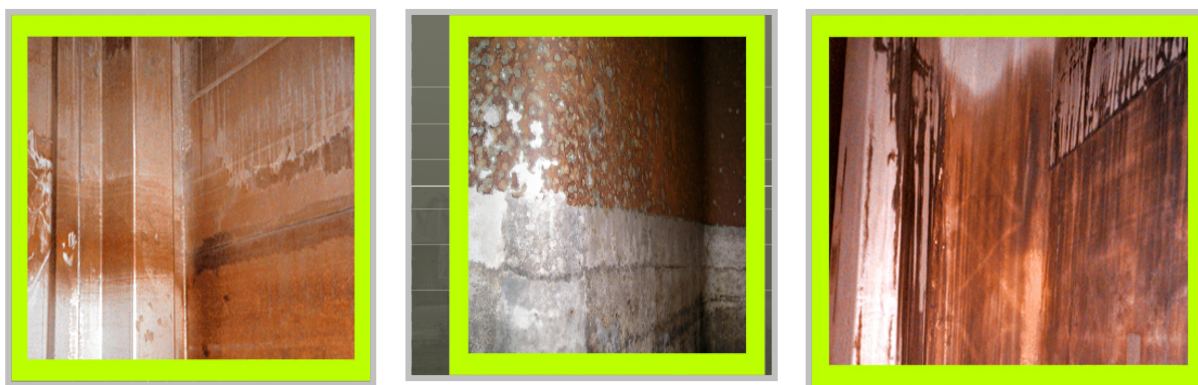
Εικόνα 45. Εξέλιξη της ομοιόμορφης διάβρωσης σε τοίχο γέφυρας
