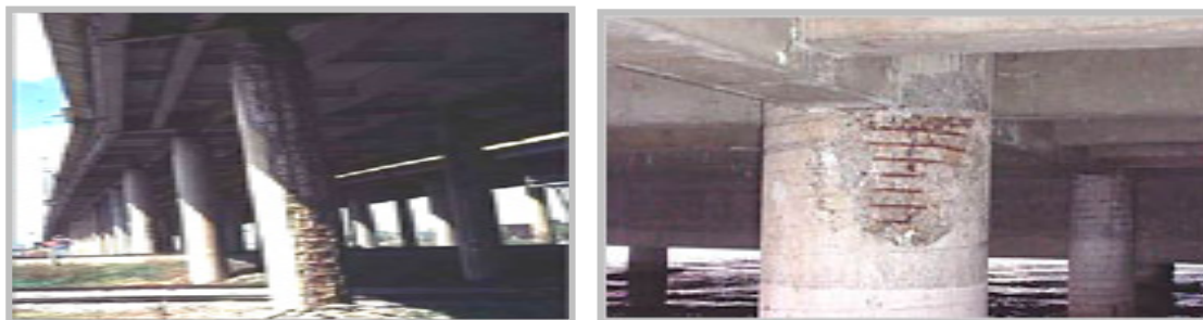
Εικόνα 43. Ενανθράκωση Σκυροδέματος στις γέφυρες
