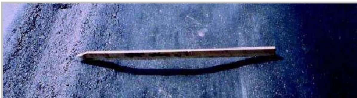
Εικόνα 15. Μέγεθος της αυλάκωση του οδοστρώματος
