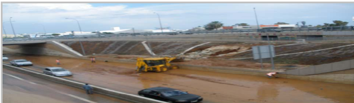
Εικόνα 34. Υποχώρηση πρανού μετά από έντονα καιρικά φαινόμενα
