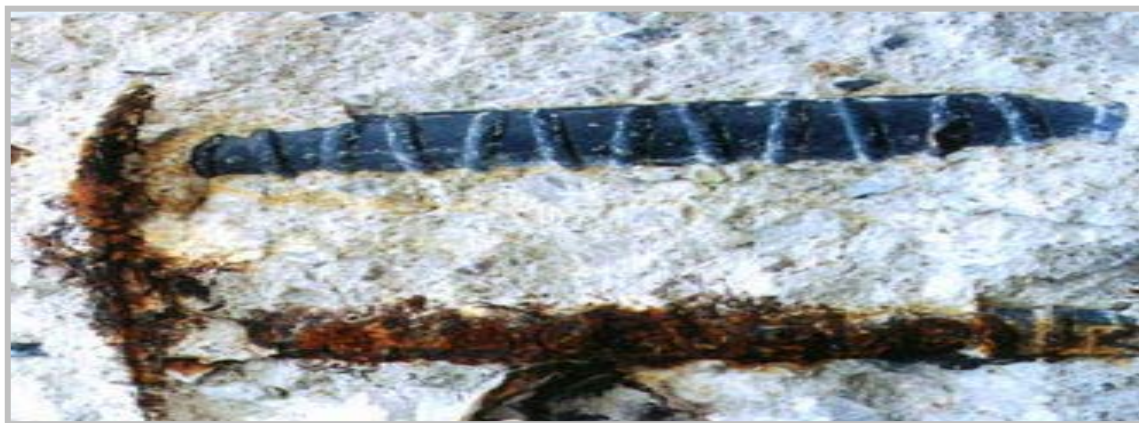
Εικόνα 44. Διάβρωση χάλυβα οπλισμού από χλωριώντα
