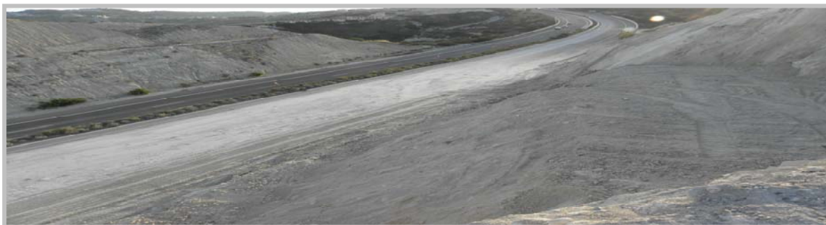
Εικόνα 33. Τεχνικό Πρανές ( αύξηση τεχνικών κλίσεων) μετά από υποχώρηση του μέσα στην Οδό
