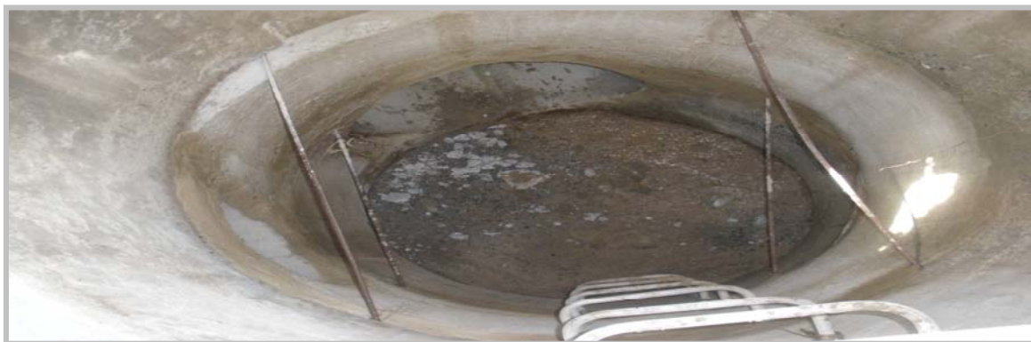
Εικόνα 40. Φράξιμο αποχετευτικού συστήματος
