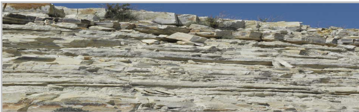
Εικόνα 32. Φυσικό Πρανές και μετά από φυσική φθορά υπάρχει πρόβλημα ευστάθειας.
