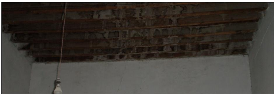
Εικόνα 60. Υγρασία ξύλινων δοκών, λόγω κακής συντήρησης της στέγης.
