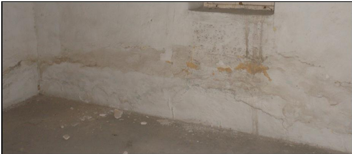
Εικόνα 52. Διάβρωση - διογκωση - χρωματισμός - ρηγμάτωση τοιχοποιίας λόγω εδαφικής υγρασίας.
