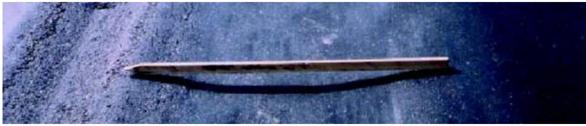
Εικόνα 1. 3 : Παραμόρφωση επιφάνειας κύλισης οδοστρώματος(ΟΕΜΚ)
