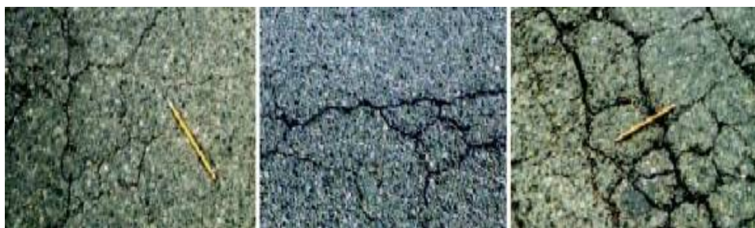
Εικόνα 1. 2: Ρωγμές τύπου αλιγάτορα (ΟΕΜΚ)
