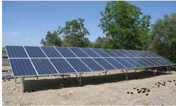
Εικόνα 1.12.2β: Φωτοβολταϊκά πλαίσια εγκατεστημένα μέσω φύτευσης στο έδαφος
