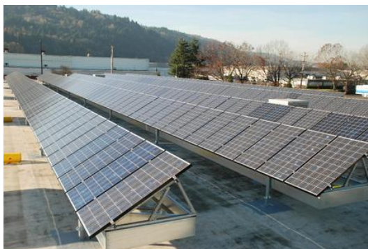
Εικόνα 1.12.2α: Φωτοβολταϊκά πλαίσια εγκατεστημένα μέσω σκυροδέτησης σε οροφή
