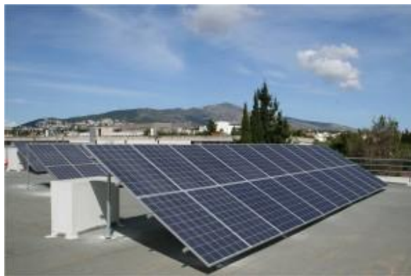
Εικόνα 1.12.1β: Φωτοβολταϊκά πλαίσια εγκατεστημένα σε οροφή
