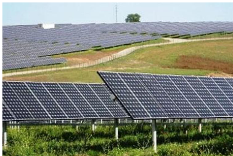
Εικόνα 1.5.2β: Φ/β πάρκο στο Τσέρι (Λευκωσία), 12 000 φ/β πλαισίων και έκτασης 4,6 εκταρίων
