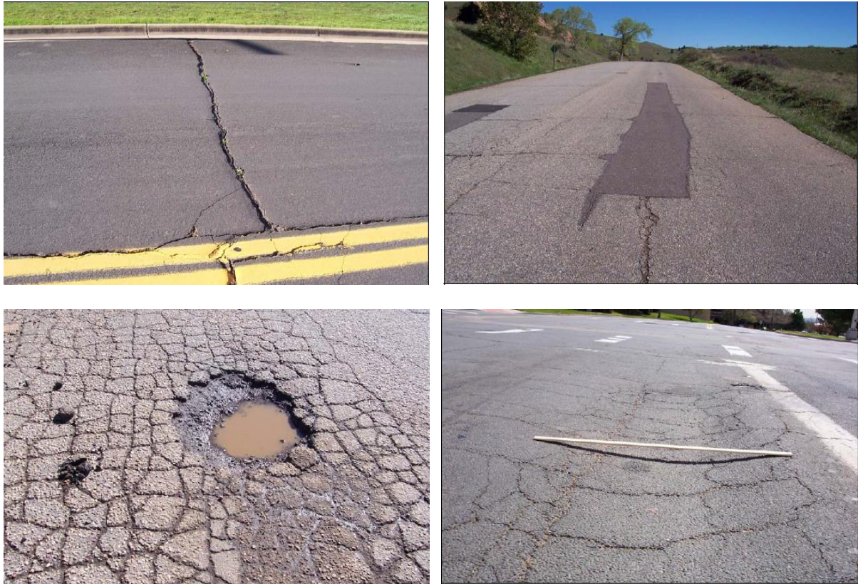
Εικόνα 1: Κύριες κατηγορίες αστοχιών των ασφαλτικών επιφανειών, πάνω αριστερά εγκάρσια ρωγμή, πάνω δεξιά ρωγμές από μπαλώματα ασφαλτικών επιφανειών, κάτω αριστερά λακκούβες σε δρόμους και κάτω δεξιά αυλακώσεις.
