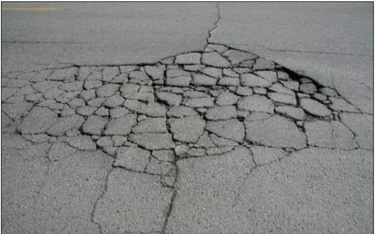
Σχήμα 1-4: Ρωγμές τύπου αλιγάτορα
