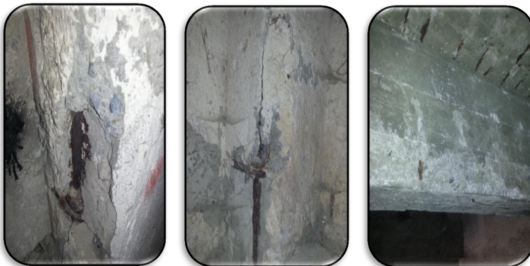
Σχήμα 3: Διαβρωμένος εκτεθειμένος οπλισμός – Πτώση επικάλυψης – Ρηγματώσεις (Πηγή: Μάθημα Ερευνητικές Μέθοδοι, Το φαινόμενο ενανθράκωση και η επιπτώσεις του στους οπλισμούς, Χρίστου Γιώργος, ΤΕΠΑΚ 2013)
