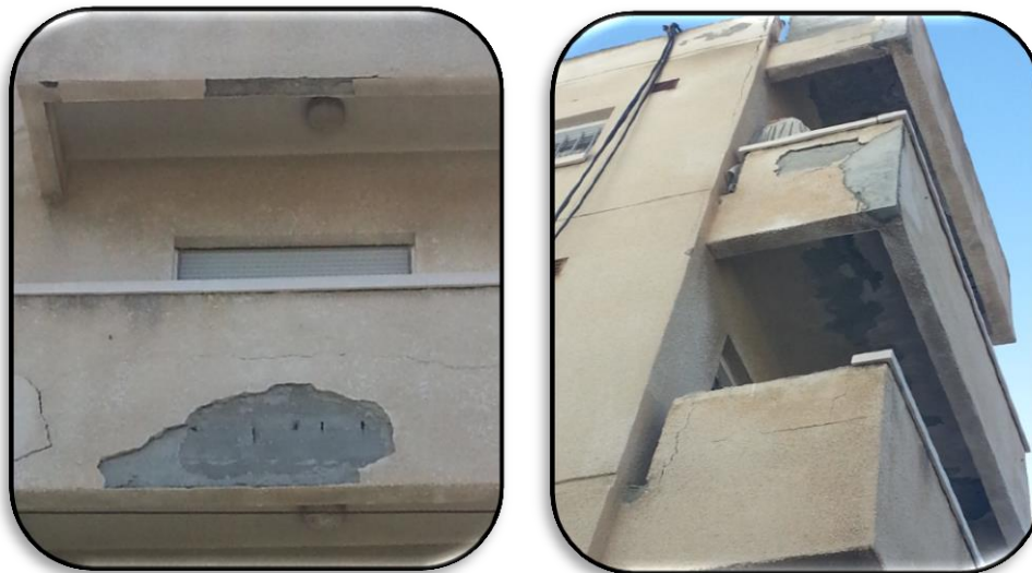
Σχήμα 2: Πτώσεις επικάλυψης οπλισμού στα μπαλκόνια (Πηγή: Μάθημα Ερευνητικές Μέθοδοι, Το φαινόμενο ενανθράκωση και η επιπτώσεις του στους οπλισμούς, Χρίστου Γιώργος, ΤΕΠΑΚ 2013)
