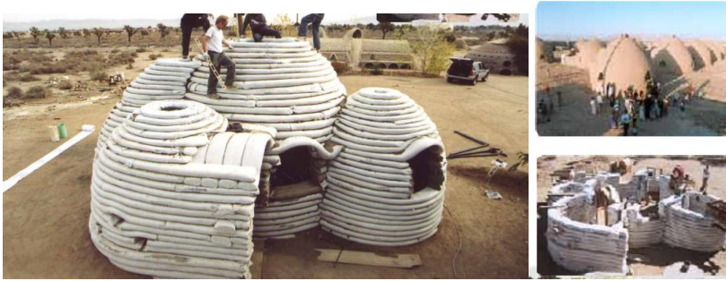
Διάγραμμα 25: Οι προσωρινές κατοικίες Sandbag Solutions, με τη χρήση χώματος και άμμου.
