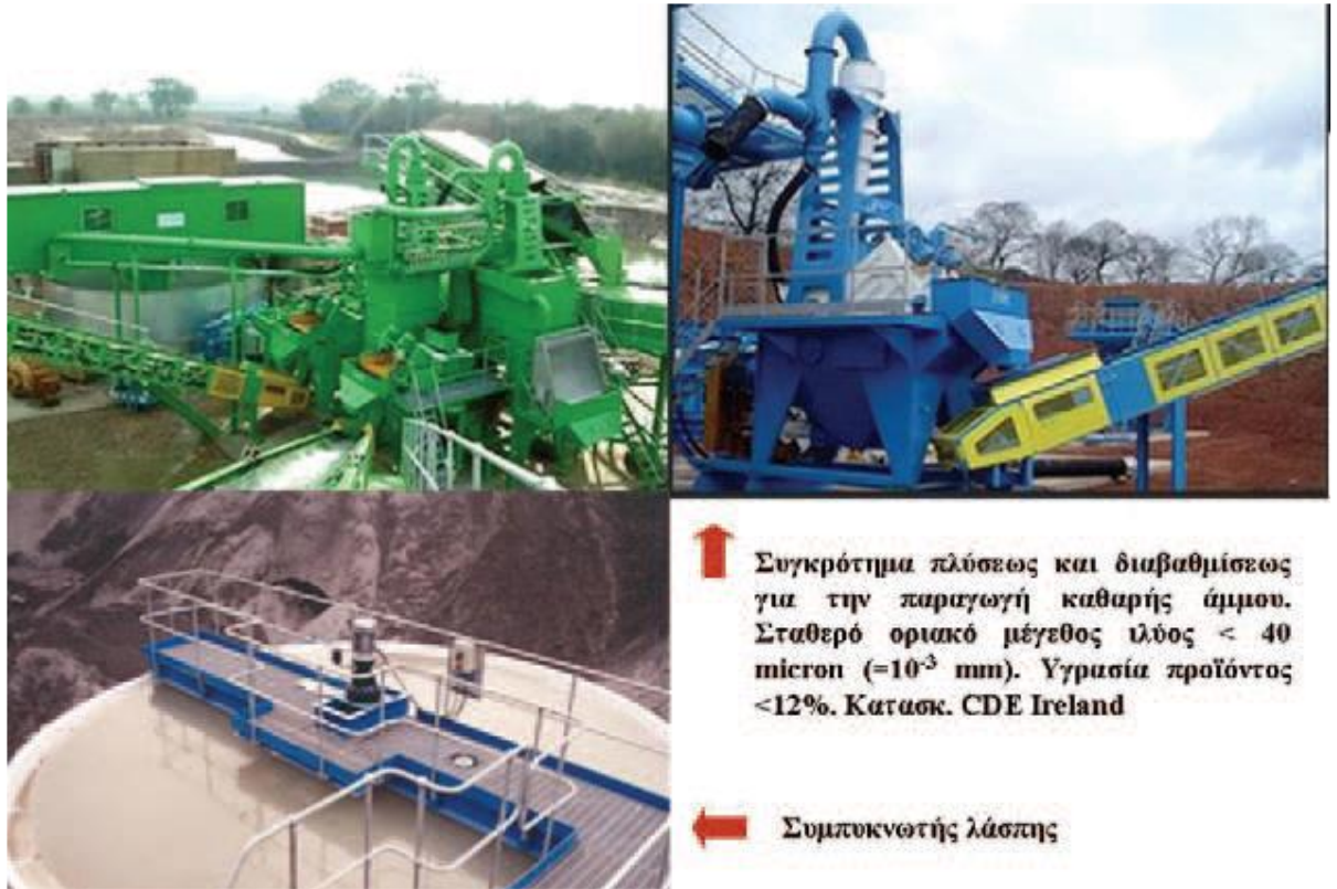
Εικόνα 1.5: Μηχανικές μονάδες του συστήματος πλύσεως και διαβαθμίσεως αδρανών υλικών από ανακύκλωση παλαιών σκυροδεμάτων (πηγή CDE Ireland)
