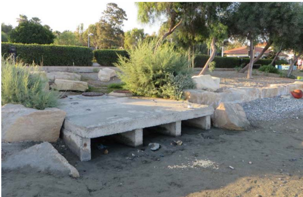
Σχήμα 2 Αγωγός όμβριων υδάτων που καταλήγει στη θάλασσα περιοχή έναντι Ζωολογικού Κήπου.
