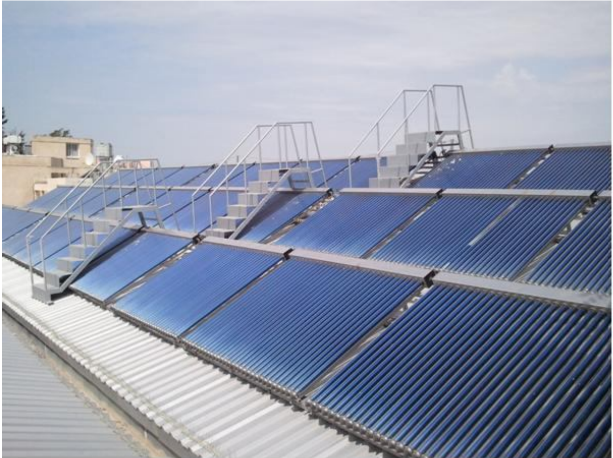
Εικόνα 20 : Ηλιακοί συλλέκτες τύπου κενού που εγκαταστάθηκαν στο κτήριο
