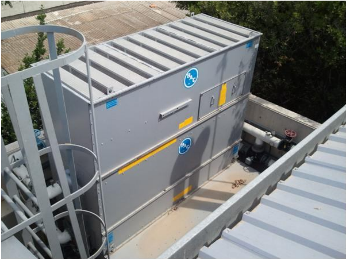
Εικόνα 19 : Υδρόψυκτος πύργος ψύξης που εγκαταστάθηκε στο κτήριο
