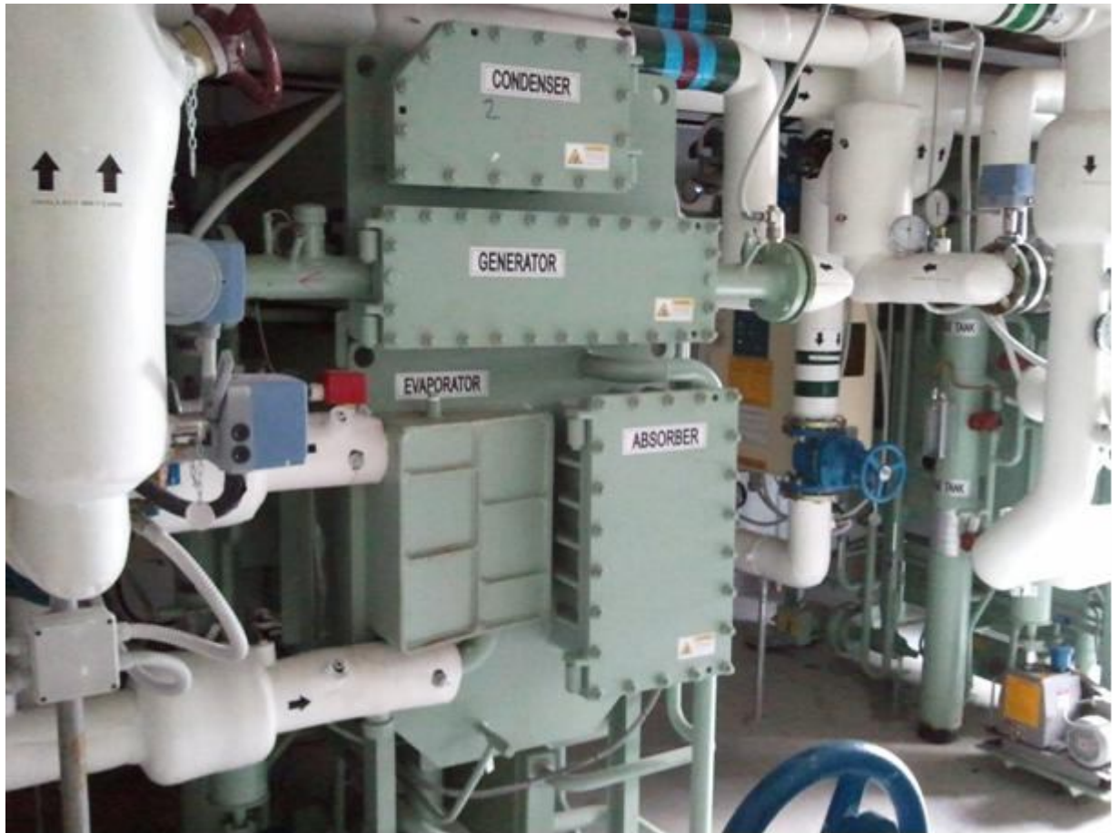
Εικόνα 23 : Ψύκτης απορρόφησης που εγκαταστάθηκε στο κτήριο
