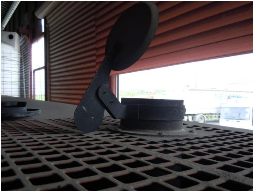
Εικόνα 4.10: Σημείο εξόδου των καυσαερίων κατά τη λειτουργία της ηλεκτρογεννήτριας με μίγμα H_2 και μαζούτ (σημείο δειγματοληψίας).
