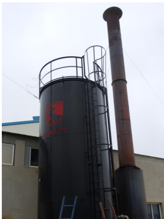
Εικόνα 4.3: Σημείο εξόδου των καυσαερίων του καυστήρα.
