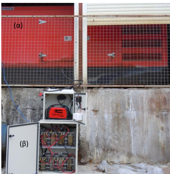
Εικόνα 4.9: Ηλεκτρογεννήτρια (α) στην οποία εγκαταστάθηκε η συσκευή ηλεκτρόλυσης (β).
