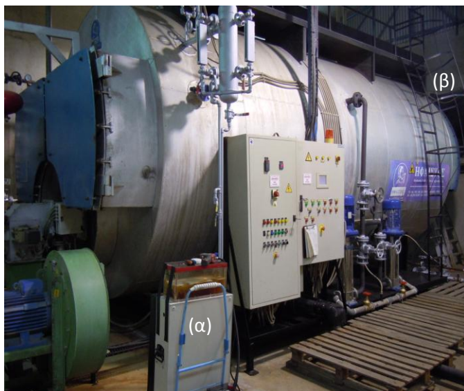
Εικόνα 4.1: Ο καυστήρας στον οποίο εγκαταστάθηκε η συσκευή ηλεκτρόλυσης. Όπου: α) η συσκευή ηλεκτρόλυσης η οποία εγκαταστάθηκε, β) το σύστημα ελέγχου συγκέντρωσης των καυσαερίων που εκπέμπονται.
