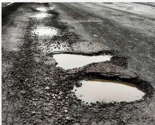
Εικόνα 1: Λακκούβα στο οδόστρωμα(traction.gr)
