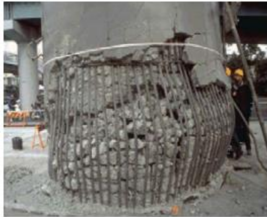
Διάγραμμα 10: Καμπτοδιατμητικού χαρακτήρα βλάβη σε υποστύλωμα (cited in Καΐρης & Χατζηβασιλειάδης 2008)
