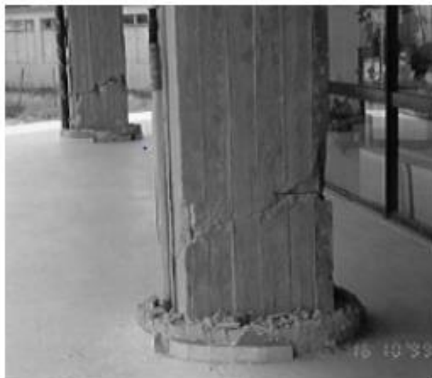
Διάγραμμα 8: Καμπτικού χαρακτήρα βλάβη σε υποστύλωμα (cited in Καΐρης & Χατζηβασιλειάδης 2008)
