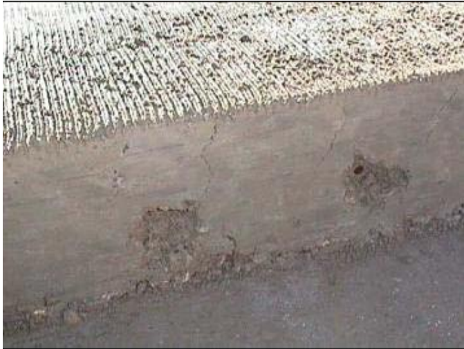
Εικόνα 1:Ρηγματώση λόγω πλαστικής συστολής
