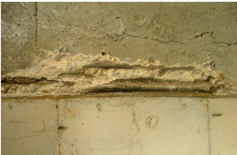
Εικόνα 15: Η 'αποκάλυψη' του οπλισμού από την αποκόλληση του σκυροδέματος.
