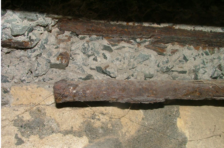
Εικόνα 18: Ο διαβρωμένος χάλυβας. Λόγω της διάβρωσης, η διατομή του χάλυβα έχει μειωθεί.
