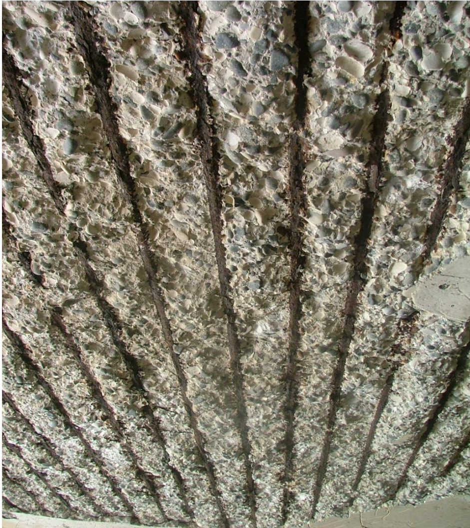
Εικόνα 14: Η μαύρη σκουριά που δημιουργείται λόγω διάβρωσης του οπλισμού.
