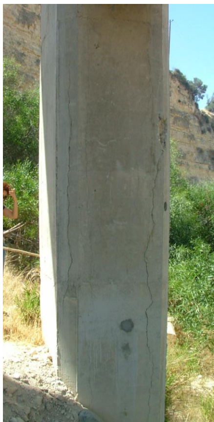
Εικόνα 2: Η διάβρωση και οι ρωγμές στα υποστηλώματα της κατασκευής
