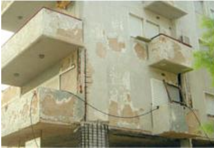
Εικόνα 9: Η διάβρωση έχει καταστρέψει όλο το κτίριο.
