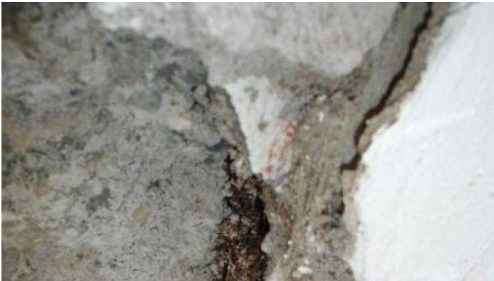
Εικόνα 8: Μαύρη σκουριά- Αποκάλυψη Οπλισμού
