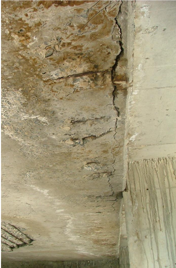
Εικόνα 16: Οι ρωγμές και το 'σκάσιμο του σκυροδέματος'.
