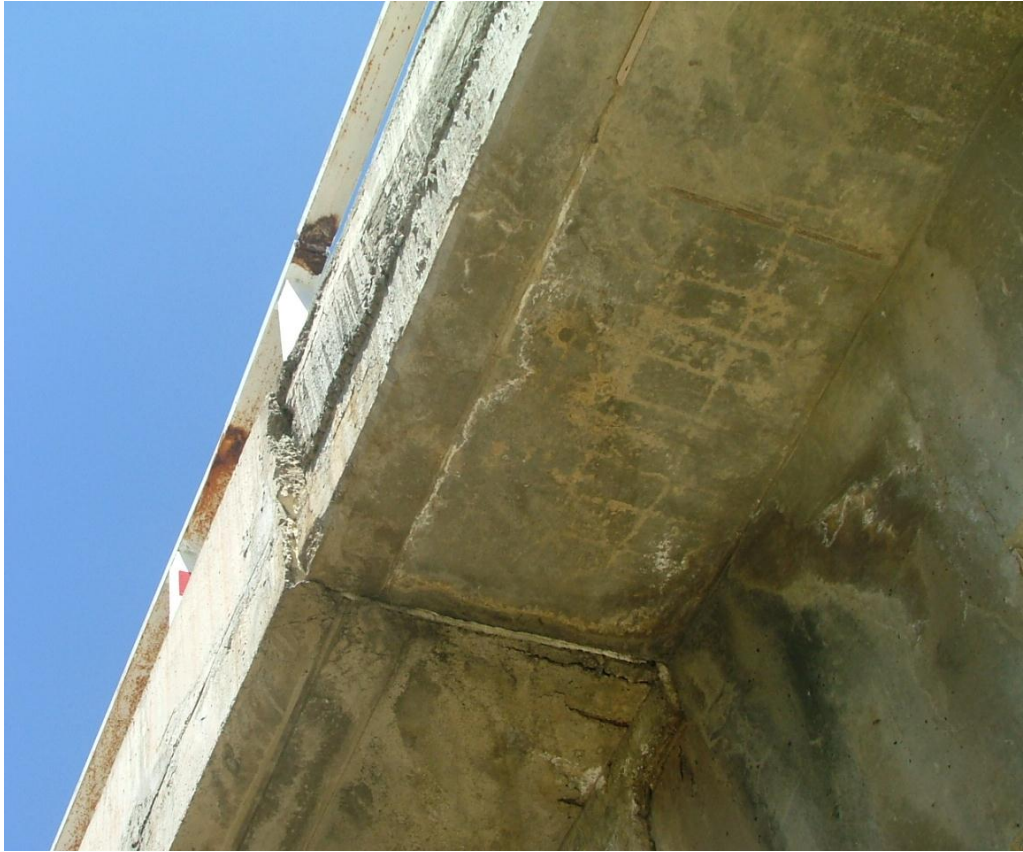
Εικόνα 5: Η μαύρη σκουρία που δημιουργήθηκε απο την διάβρωση του οπλισμού.
