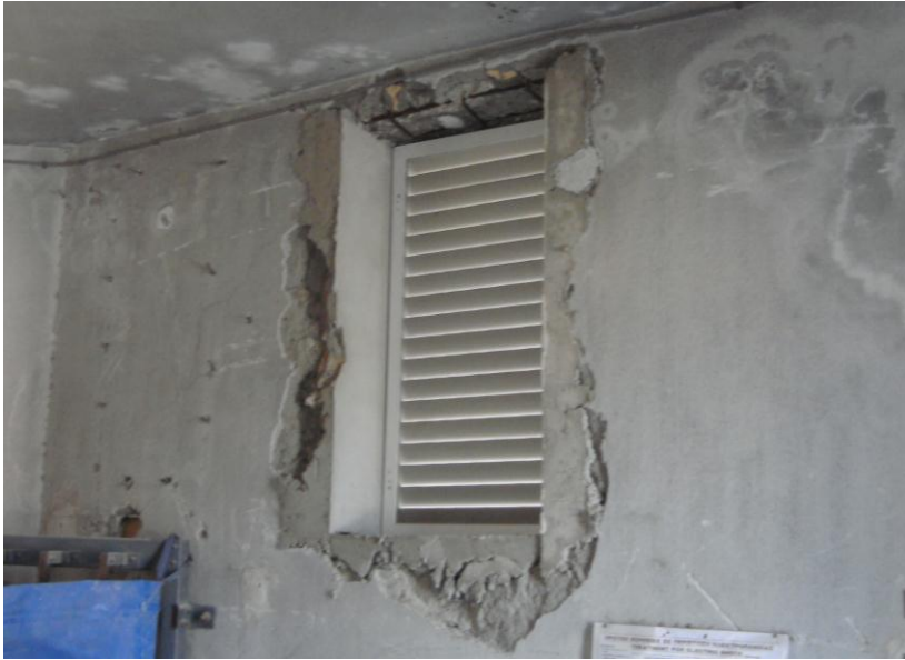
Εικόνα 7: Η εικόνα αυτή είναι από Υποσταθμό Μεταφοράς της Αρχής Ηλεκτρισμού. Στον συγκεκριμένο Υποσταθμό ο οπλισμός έχει υποστεί διάβρωση και το μπετόν έχει αποσαθρωθεί.
