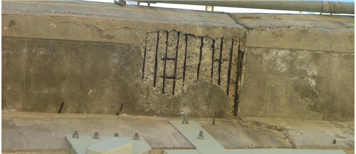
Εικόνα 3: Αποκόλληση μέρους του σκυροδέματος λόγω διάβρωσης του οπλισμού.
