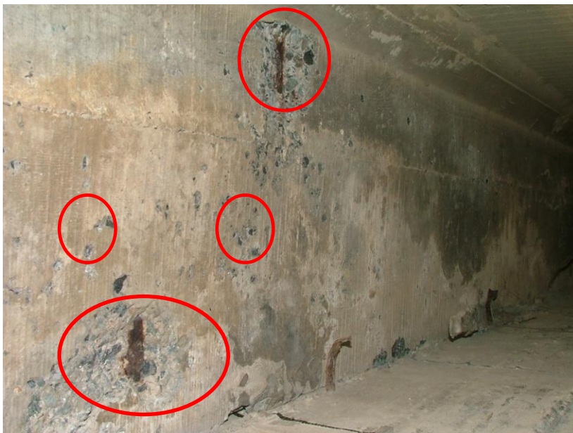
Εικόνα 17: Η αποσάθρωση του σκυροδέματος κατά μήκος της κατασκευής και αποκάλυψη του χάλυβα.
