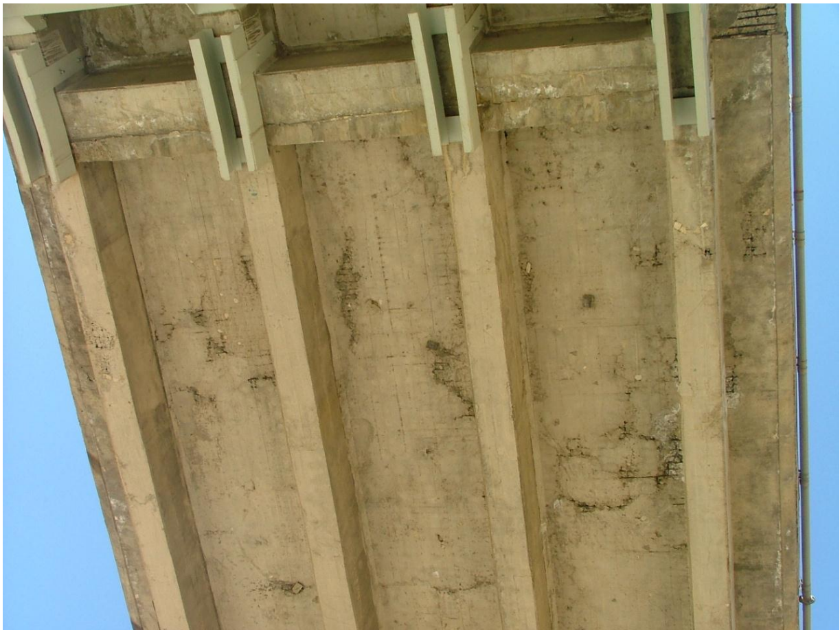
Εικόνα 4: Διάβρωση οπλισμού του καταστρώματος της γέφυρας, δημιουργία ρωγμών και αποκάλυψη του χάλυβα
