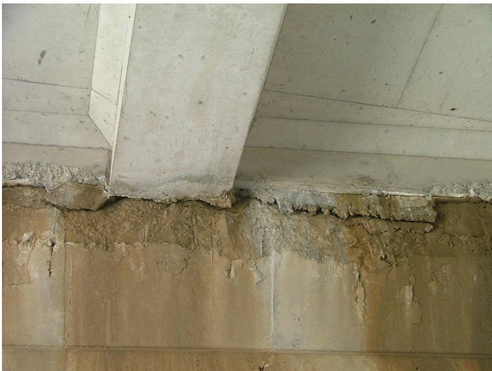
Εικόνα 6: Αποσάθρωση του σκυροδέματος.
