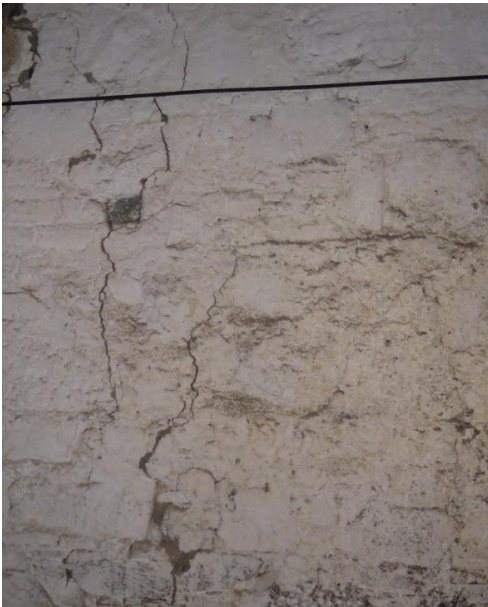
Εικόνα 93: Ρωγμές σε τοιχοποιία
