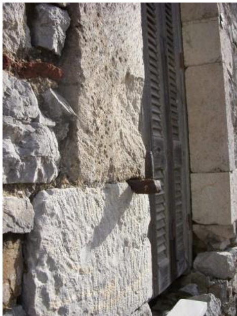
Εικόνα 73: Μεταλλικό στοιχείο σφηνωμένο ανάμεσα σε λίθους
