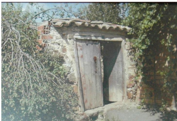
Εικόνα 66: Ξωπόρτι πριν την αποκατάσταση
