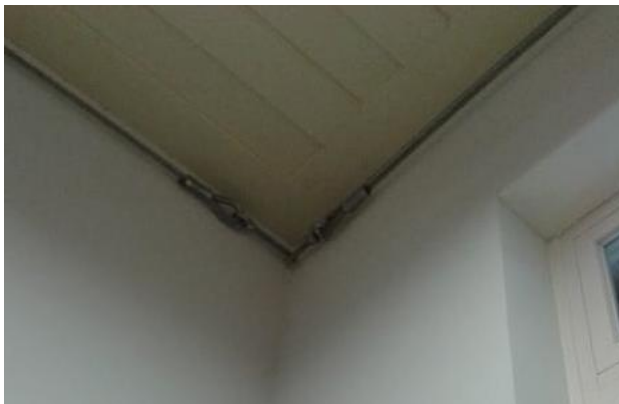
Εικόνα 103: Τένοντες στον εσωτερικό χώρο
