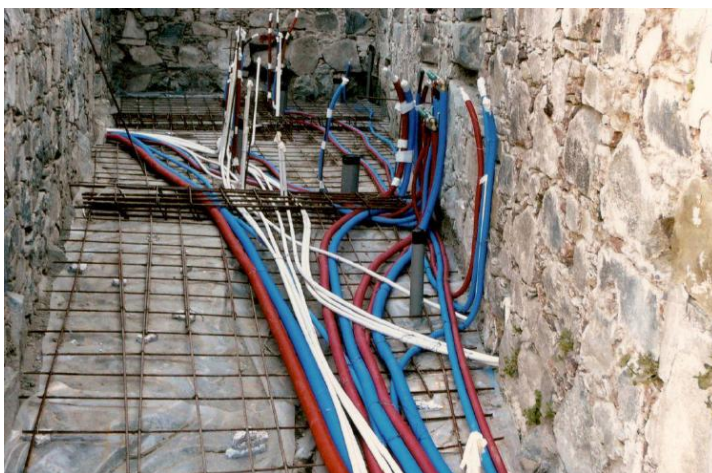
Εικόνα 46: Διέλευση ηλεκτρολογικών εγκαταστάσεων
