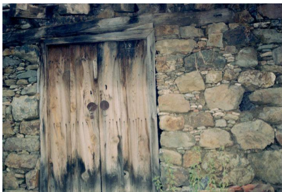
Εικόνα 50: Κούφωμα οικίας πριν την αποκατάσταση
