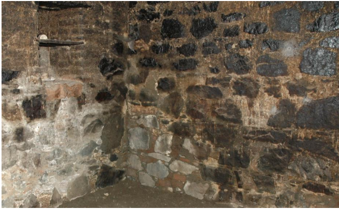
Εικόνα 87: Τοιχοποιία στην αρχική της κατάσταση
