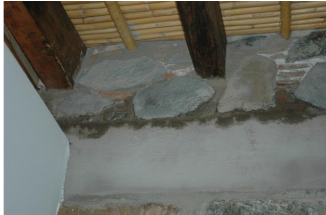
Εικόνα 88: Διείσδυση υγρασίας στην τοιχοποιία
