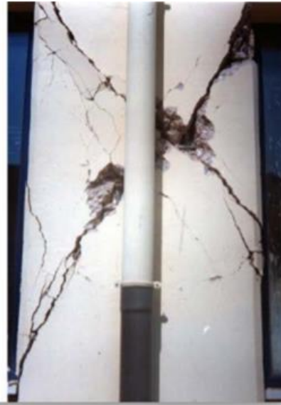
Εικόνα 6: Χιαστί λοξές διατμητικές ρωγμές βαθμού βλάβης c ( http://www.episkeves2.civil.upatras.gr )
