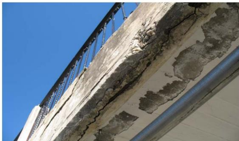
Εικόνα 29: Ομοιόμορφη διάβρωση ( http://www.episkeves2.civil.upatras.gr )
