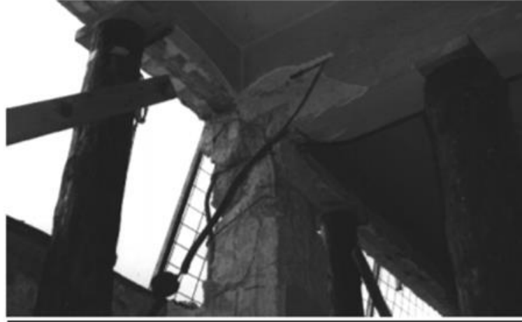
Εικόνα 22: Βλάβη σε μεσαίο κόμβο ( http://library.tee.gr )
