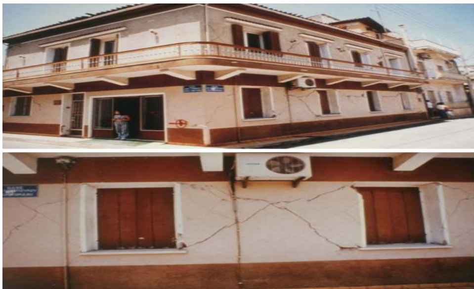
Εικόνα 44: Γ βαθμός βλάβης σε άοπλη τοιχοποιία ( https://eclass.uoa.gr )
