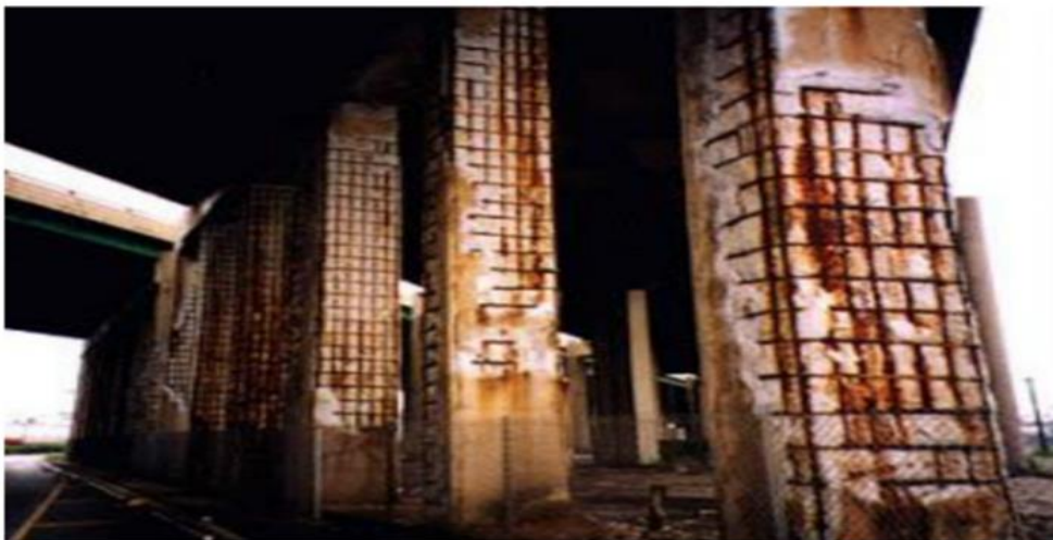
Εικόνα 27: Διάβρωση οπλισμού υποστυλωμάτων
