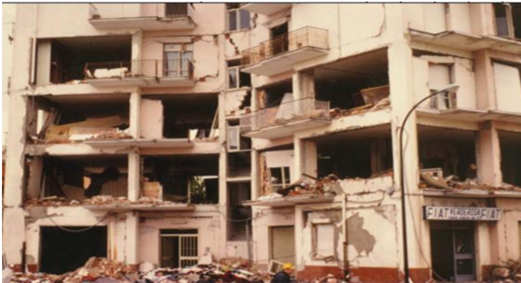
Εικόνα 47: Δ βαθμός βλάβης σε κατασκευή από οπλισμένο σκυρόδεμα ( https://eclass.uoa.gr )
