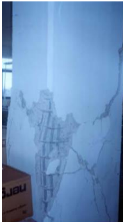
Εικόνα 4: Διατμητική αστοχία κοντού υποστυλώματος
