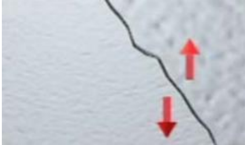
Εικόνα 33: Ρηγμάτωση που οφείλεται σε διάτμηση λόγω καθίζησης ( http://5a.arch.ntua.gr )
