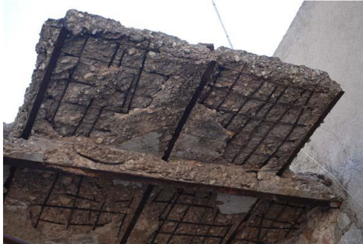
Εικόνα 36: Ασβεστοποίηση σκυροδέματος ( https://www.skyrodema2018.g )
