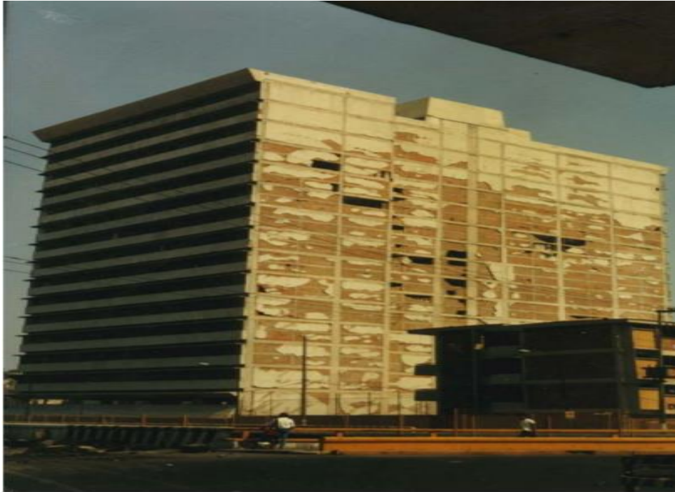
Εικόνα 43: Γ βαθμός βλάβης σε κτίριο από οπλισμένο σκυρόδεμα ( https://eclass.uoa.gr )
