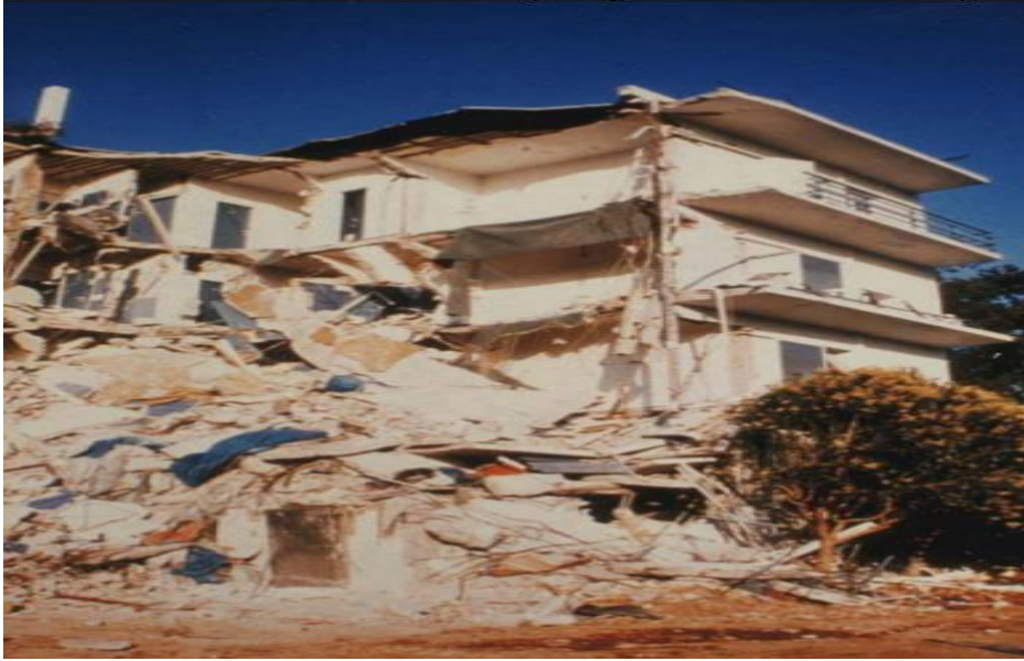
Εικόνα 48: Ε βαθμός βλάβης σε κατασκευή από οπλισμένο σκυρόδεμα ( https://eclass.uoa.gr )
