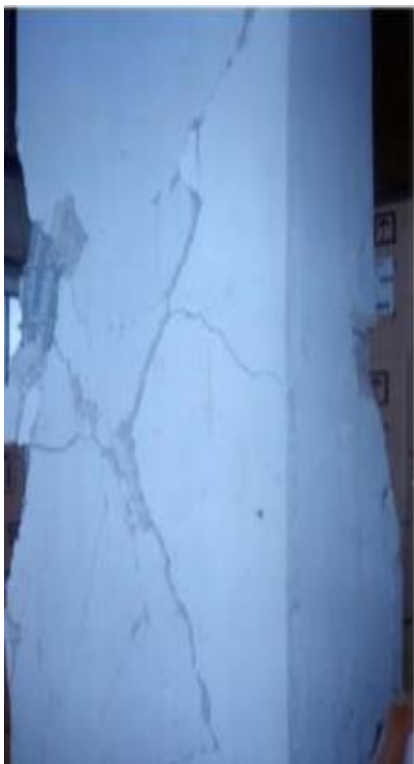
Εικόνα 5: Διατμητική αστοχία κοντού υποστυλώματος
