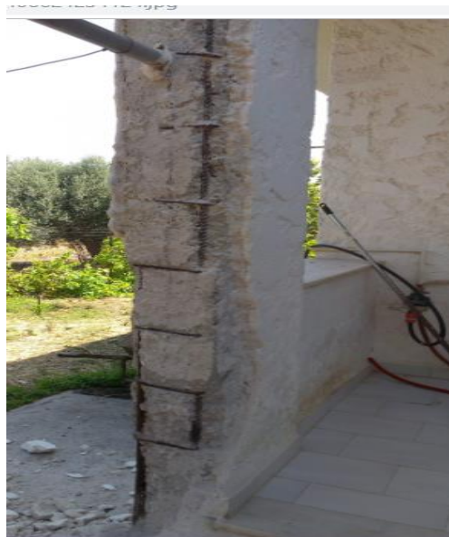
Εικόνα 35: Ενανθράκωση σκυροδέματος ( https://www.eletech.gr )
