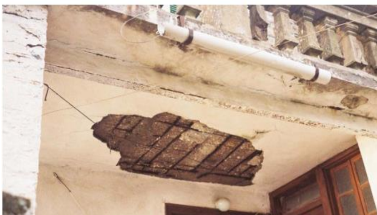
Εικόνα 30: Τοπική διάβρωση ( http://www.episkeves2.civil.upatras.gr )
